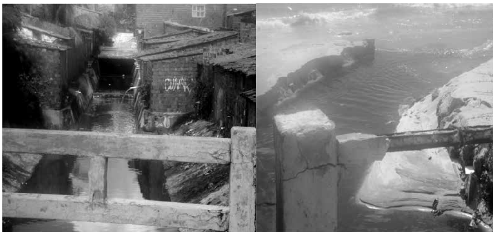
Figura 1 - Aspecto de galeria pluvial utilizada para descarga de efluentes domésticos na zona costeira, provenientes de casebres da Praia das Goiabeiras, Fortaleza, Ceará.
