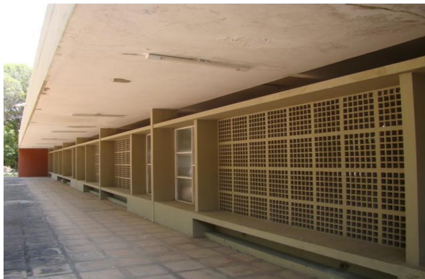
Figura 10 : Restaurante Universitário do Campus do Pici/UFC Arq. Neudson Braga Fonte: Acervo Clóvis Jucá
