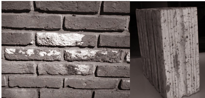
Fig. 1 - Eflorescência em tijolos com alteração na coloração e escamação.
