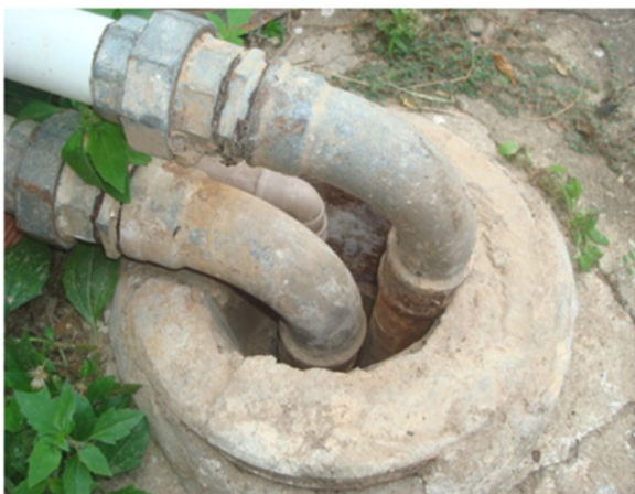
Figura 6: Poço sem a devida completação. Faltam a laje de proteção, tamponamento (o poço encontra-se aberto), além de estar praticamente ao nível do solo, mostrando a clara falta de atenção com a obra de captação, comum em todos os 18 poços vistoriados (08/2012). Localização no centro onde está instalada a Prefeitura Municipal de Frecheirinha. Coordenadas do poço: 298472/9584672 (UTM SAD 69).
