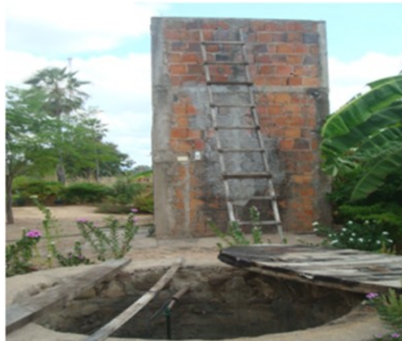
Figura 8: Cacimba aberta, praticamente ao nível do solo e tendo ao seu lado construído um banheiro. Isso acarreta um potencial de contaminação às águas subterrâneas, além do risco à população, notadamente relacionado às pessoas mais velhas e crianças (08/2012). Coordenadas da cacimba: 297478/9583274 (UTM SAD 69).
