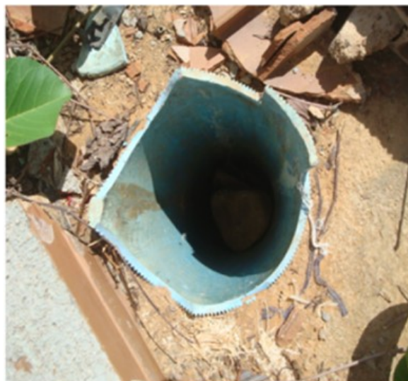
Figura 7: Poço abandonado localizado no Centro Social Urbano, de maneira completamente inadequada (ao nível do solo e aberto), mostrando uma potencial fonte de poluição do aquífero e uma completa desconsideração com a obra pública e políticas de proteção do município. Coordenadas do poço: 298906 /9584170 (UTM SAD 69).
